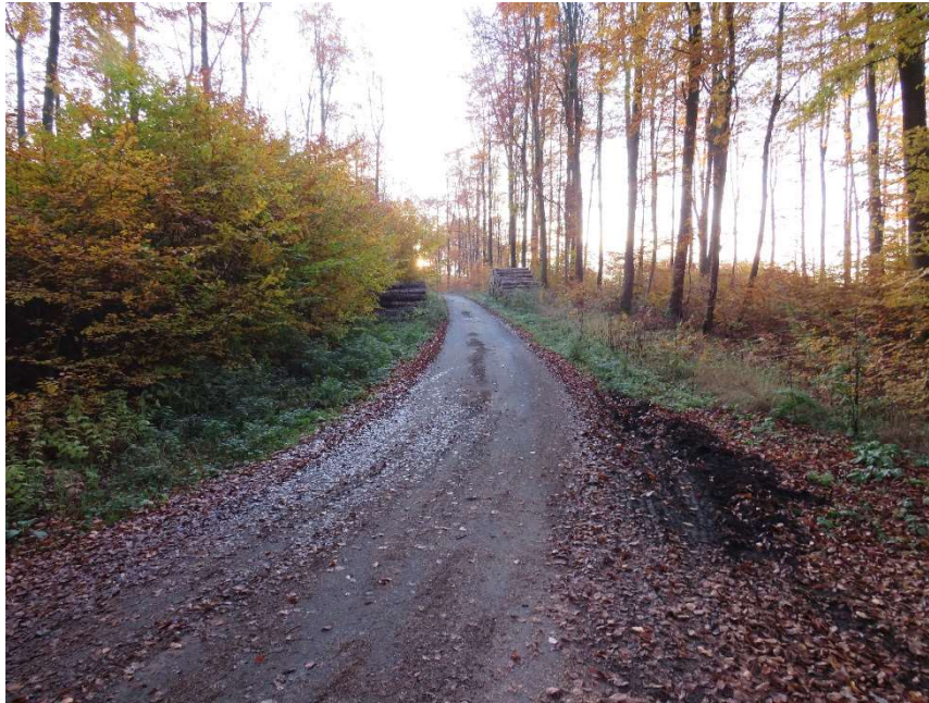
E.Nr. 201.20: Blickrichtung von E.Nr. 201.10 in Richtung Osten. Es sind deutliche Verdrückungen im Seitenbereich erkennbar.
