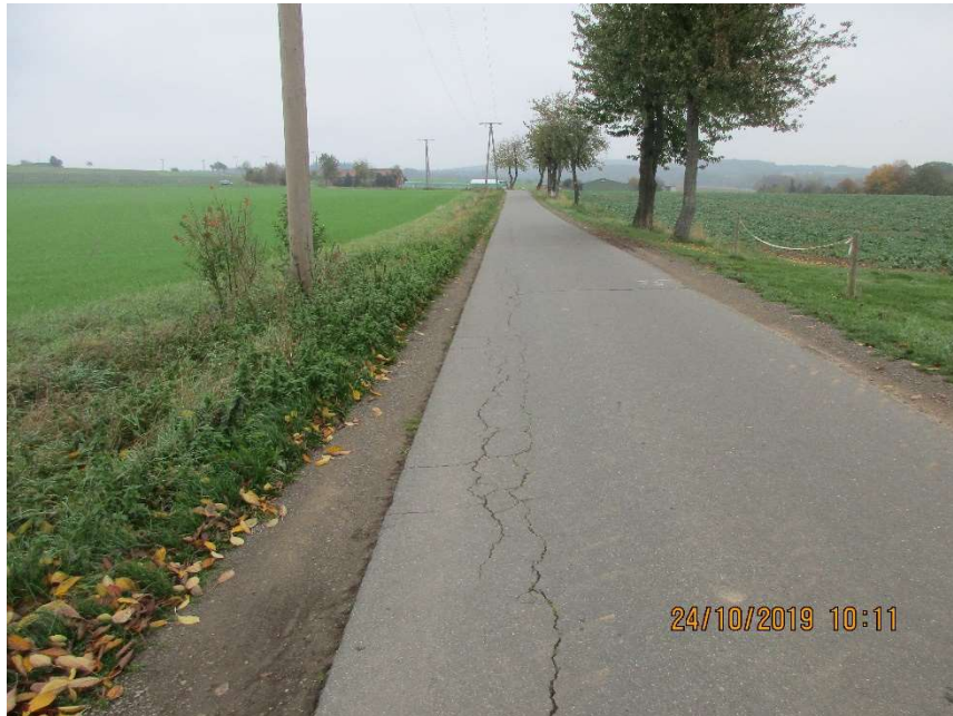
E.Nr. 119.20: Deutliche Längsrisse im südlichen Bereich der Ausbaustrecke.
