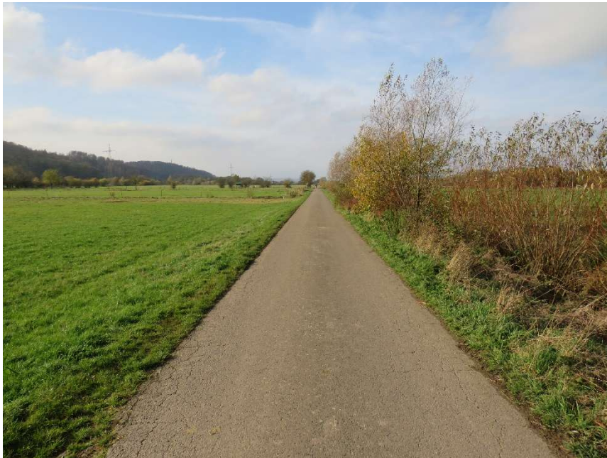
E.Nr. 116.20: Blick von Ost nach West. Die deutlichen Längsrisse und die Verdrückungen im Randbereich weisen auf eine zu geringe Tragfähigkeit hin
