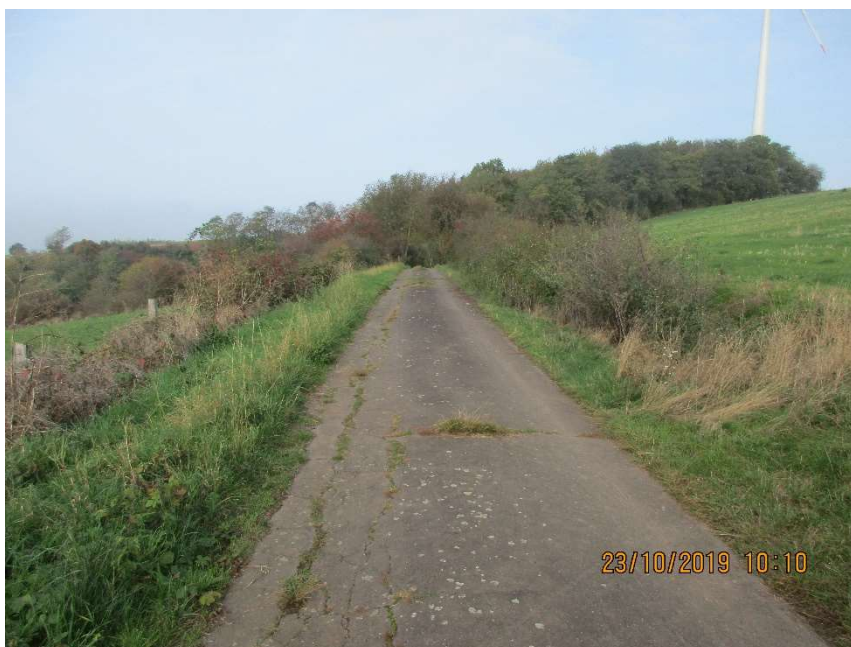
E.Nr. 114: Blick von Ost nach West. Die deutlichen Längsrisse weisen auf eine zu geringe Tragfähigkeit hin
