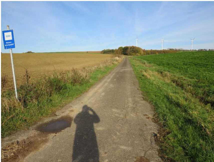
E.Nr. 102: Blickrichtung von Südwest nach Nordost. Die deutlichen Längsrisse weisen auf eine zu geringe Tragfähigkeit hin.
