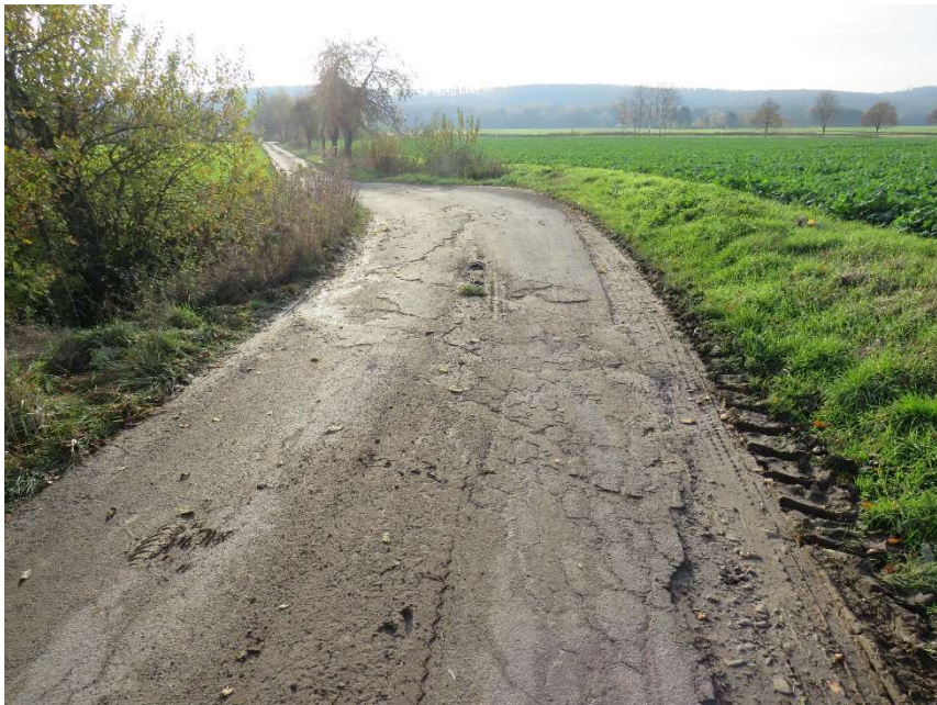
E.Nr. 103.20: Blick von Nord nach Süd. Die deutlichen Längsrisse weisen auf eine zu geringe Tragfähigkeit hin.
