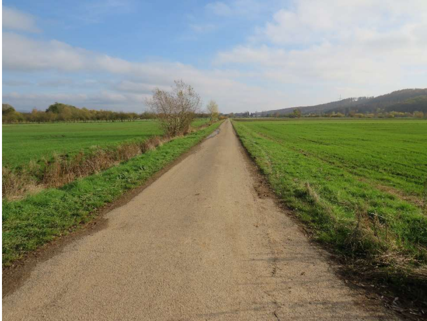
E.Nr. 116.10: Blickrichtung von Westen Richtung Osten. Es sind Längsrisse und Absenkungen im Bereich des Wegeseitengrabens erkennbar.
