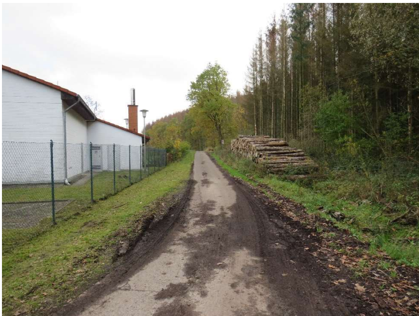
E.Nr. 200: Blick von West nach Ost. Die deutlichen Längsrisse weisen auf eine zu geringe Tragfähigkeit hin
