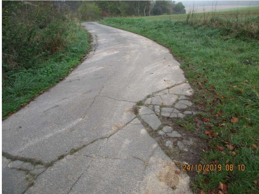
E.Nr. 120: Blickrichtung von Nordwest Richtung Südost. Deutliche Schäden an der Bitdecke.
