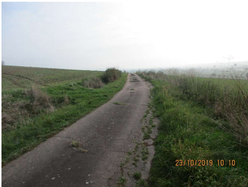
E.Nr. 114: Blickrichtung von Osten nach Westen. Die deutlichen Längsrisse weisen auf eine zu geringe Tragfähigkeit hin.
