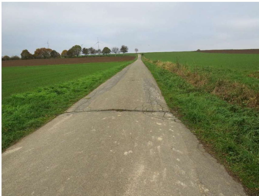
E.Nr. 108: Blick von Süd nach Nord. Die deutlichen Längsrisse weisen auf eine zu geringe Tragfähigkeit hin
