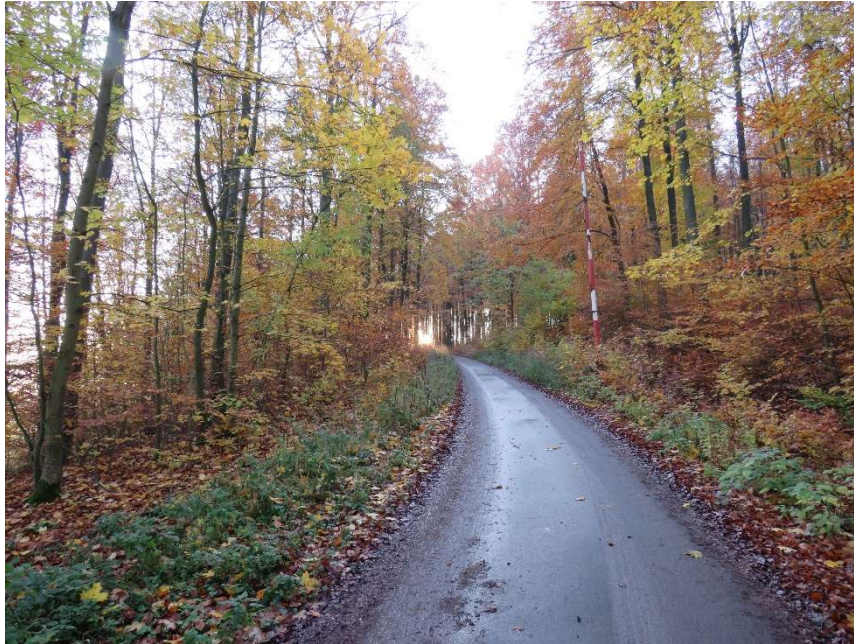
E.Nr. 201.10: Blickrichtung von E.Nr. 200 in Richtung Südosten. Es sind deutliche Verdrückungen im Seitenbereich erkennbar.
