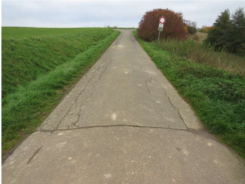
E.Nr. 108: Blickrichtung von der Verfahrensgrenze Richtung Norden. Die deutlichen Längsrisse weisen auf eine nicht ausreichende Tragfähigkeit hin.
