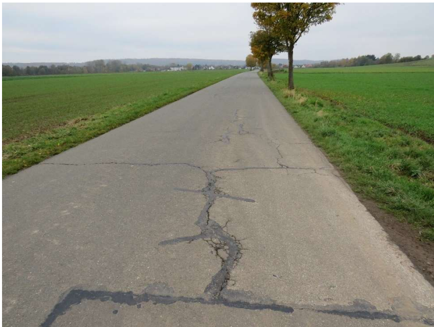
E.Nr. 20: Blickrichtung von Osten Richtung Hattorf. Deutliche Schäden an der Fahrbahndecke sind sichtbar.
